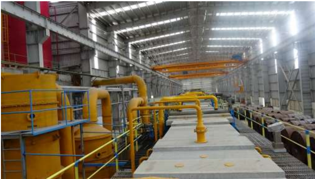
Die Beiztanks der Schubbeize sind komplett aus Granit gefertigt.
