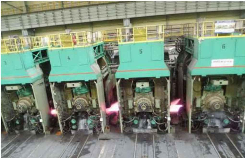
Fertigstraße Gerüste F3 bis F6 bei der Walzung eines Bandes.
