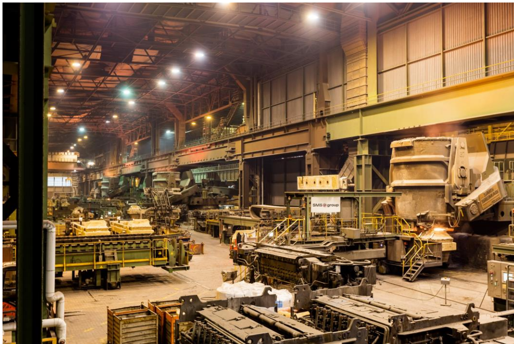
Drehturm der Stranggießanlage Nr. 2. Die vier Stranggießanlagen im Werk der Salzgitter Flachstahl wurden von SMS group geliefert. Foto: Salzgitter Flachstahl.
