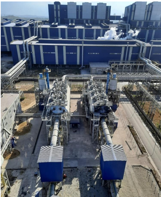
Umwelttechnik der SMS group: Elektrotrockenfilter der neuesten Generation.
