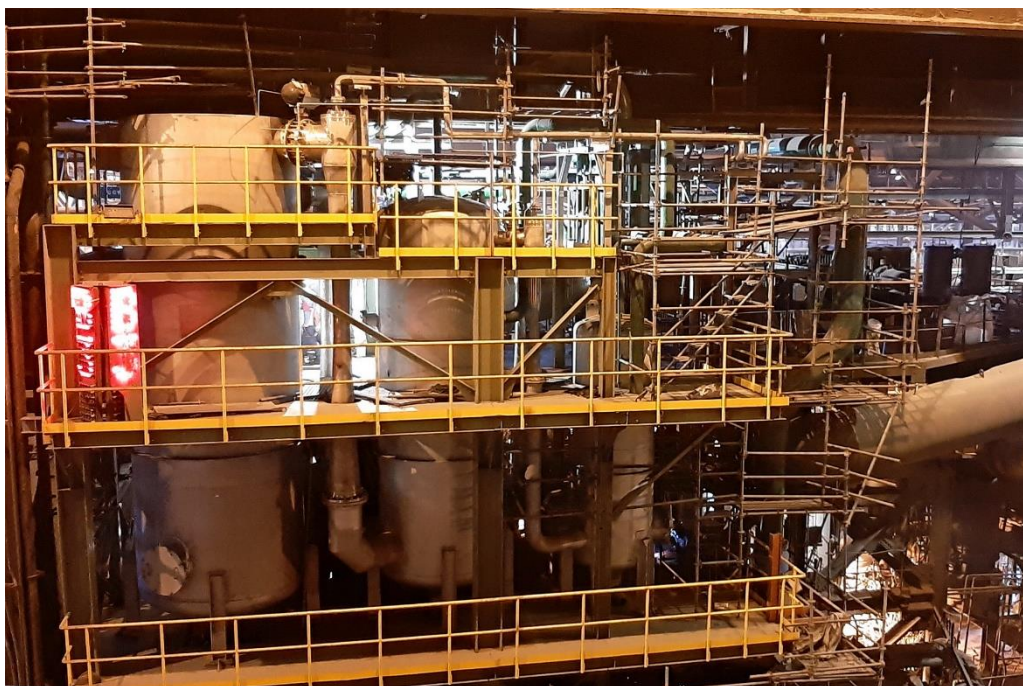
Die von der SMS modernisierte RH-Anlage bei CSC, Taiwan.
